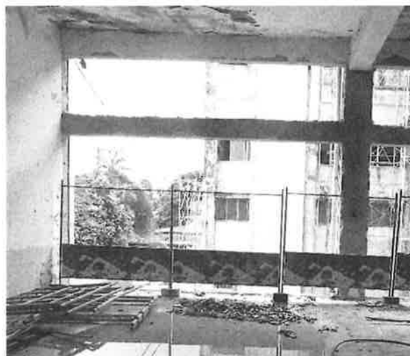
開口部分未設置足夠強度之護欄
