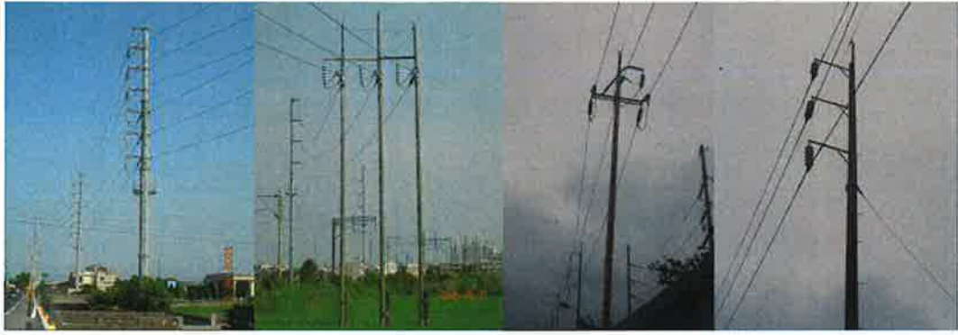
圖 2-5 電桿型支持物外觀(大部份用於 69 千伏)
